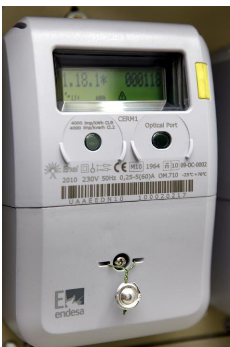
Nuevo telecontador de Endesa.
