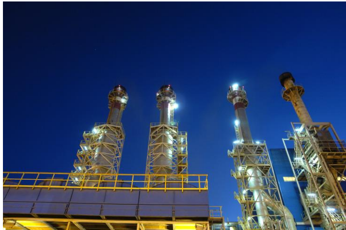
Imagen nocturna de la central de Las Salinas, en Fuerteventura.
